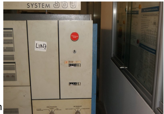
Abbildung 4: Not-aus-Knopf, darunter Betriebsstunden- und Technikerzähler
