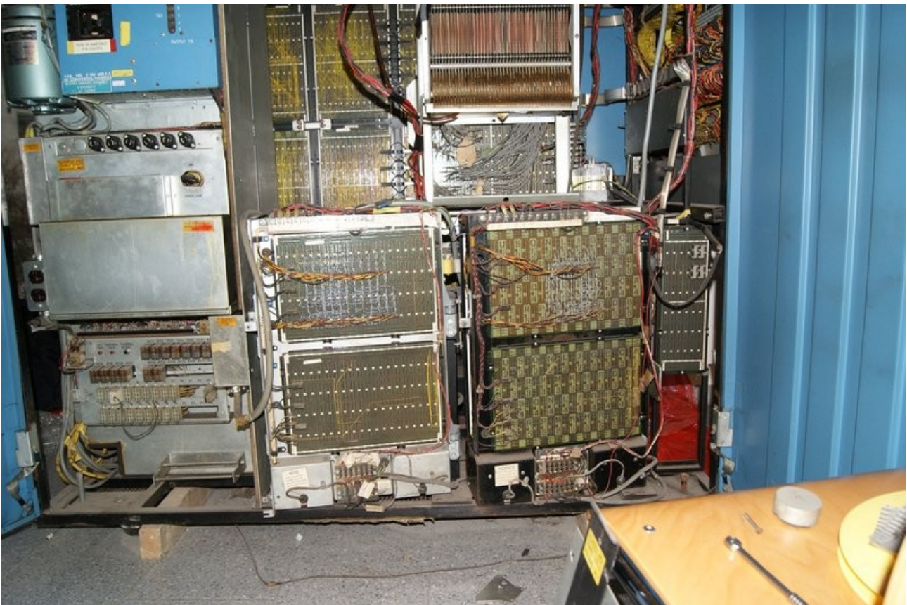
Abbildung 5: Seitenansicht der /360: Unten die beiden Kernspeichermodule, darüber Teile des CCROS, im Hintergrund die Logik, links oben der CCROS-Kompressor
